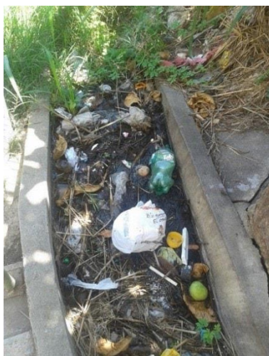
Figura 4. Canaleta com folhas, galhos e resíduos sólidos.
