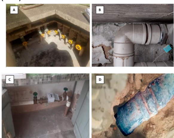
Figura 5. Registros fotográficos obtidos na visita ao edifício. A – Registros das prumadas de distribuição no Barrilete de distribuição de água na cobertura do edifício; B – Barrilete 85DN; C – Hidrômetro geral; D – Tubulação antiga de ferro fundido.
