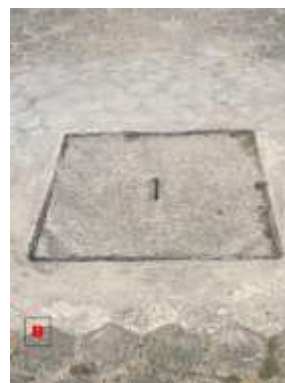
b) Tampa de caixa de inspeção travada.
