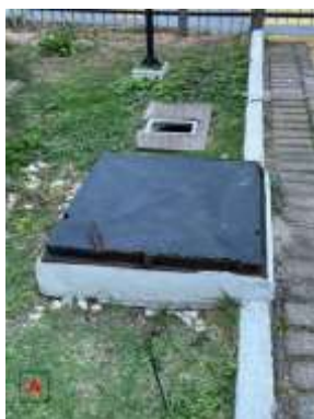
a) Tampa do reservatório inferior.
