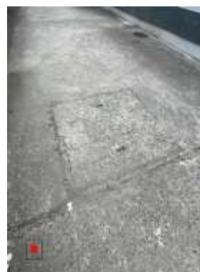
b) Tampa da caixa de inspeção travada.
