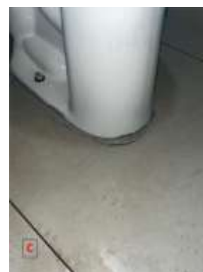
c) Vazamento na bacia sanitária.
