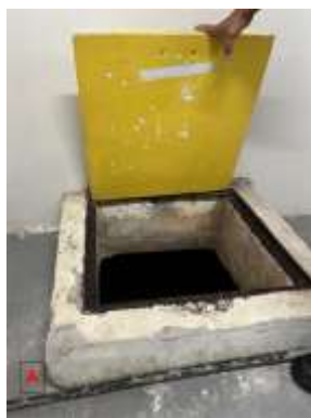
a) Tampa inadequada do reservatório inferior.
