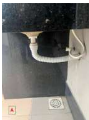
a) Sifão posicionado inadequadamente.
