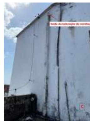
c) Saída de gases da tubulação de ventilação.
