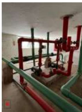
b) Barrilete do reservatório do anexo A
