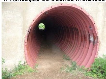
Foto 1: Passagem de fauna seca com emprego de bueiros metálicos corrugados (BR 471/RS – Estação Ecológica do Taim).
