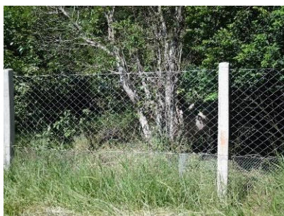
Foto 3: Animal amarrado indevidamente no mourão de concreto que compõem a estrutura da cerca guia de fauna (BR 386/RS, 13/01/2015).
