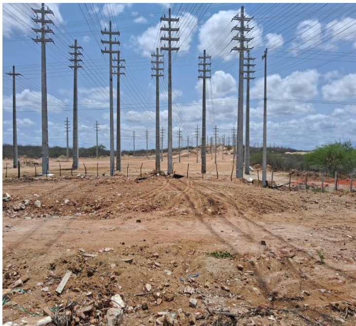
Imagem 2 - Linhas de Transmissão próximas ao CESA, na região Central do RN.
