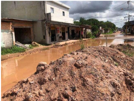
Figura 15. Avenida Carlos Prestes Trecho II: Na mesma avenida observa-se a grande presença de entulho gerado pela obra e concentração de água, fatores que dificultam a locomoção dos residentes (Foto: autores, julho de 2022).
