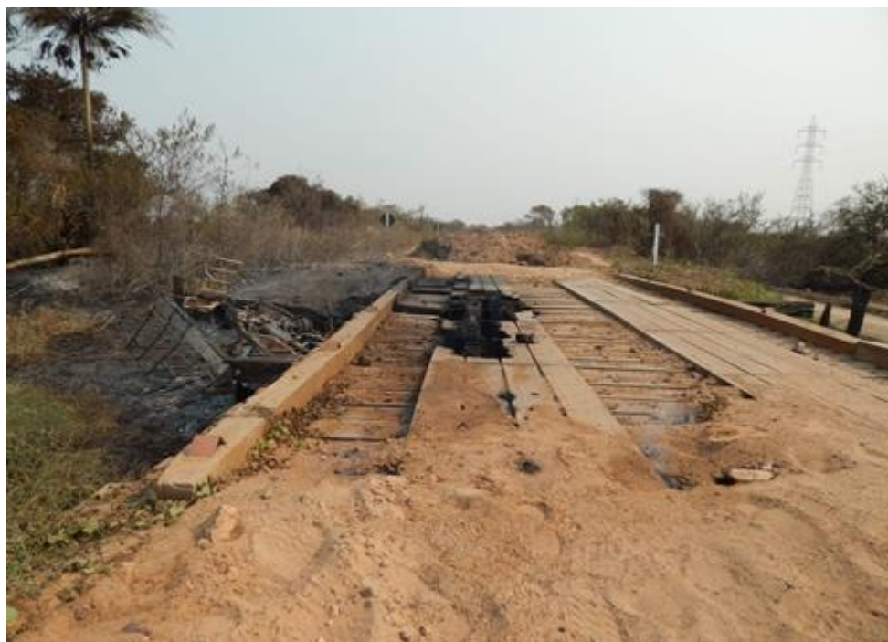
Figura 3. A mesma ponte de madeira da Figura 02 após o início da queimada. A seta indica um veículo que caiu no vão da ponte em meio à fumaça. Fonte: MARCELO, L. F. (2020)
