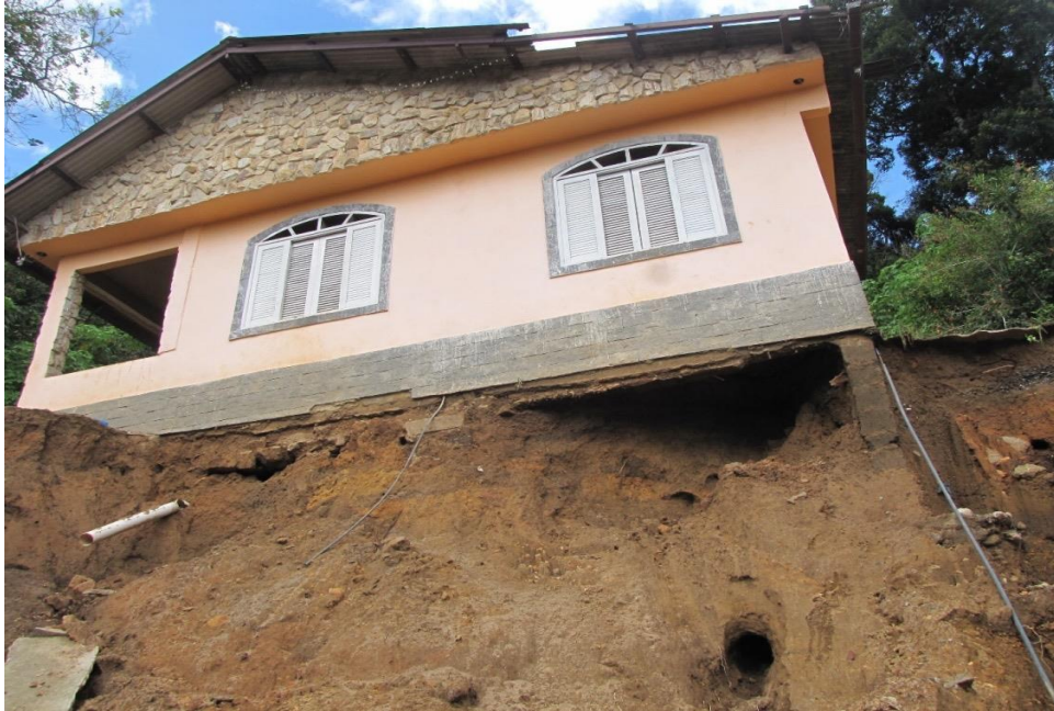
Figura 6. Cicatriz de movimento de massa, abaixo de uma casa condenada pela Defesa Civil, no bairro do Quitandinha, Petrópolis, Rio de Janeiro.
