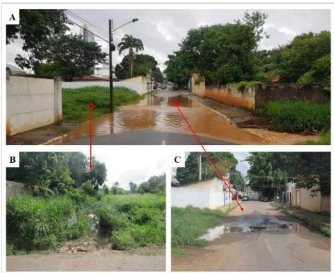
Figura 7. Problemas de drenagem na rua Arnóbio Barcelar Caneca em Juazeiro do Norte - CE
