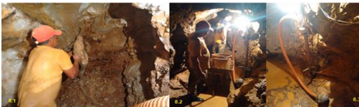
Figura 16. Possíveis Riscos Identificados in-loco
