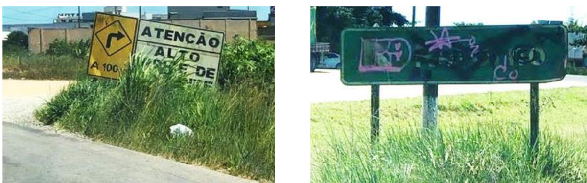
Figura 12 - Sinalização vertical prejudicadas, com necessidade de manutenção.
