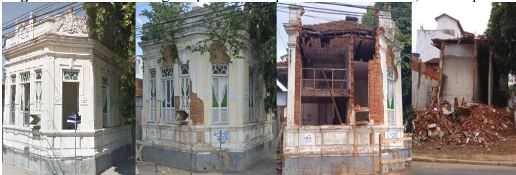
Figura 4 - Processo de degradação até o colapso da “casa da árvore”, em Campos
