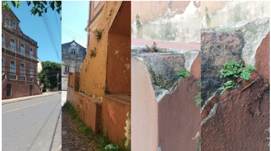
Figura 6 Prédio histórico – Fundação Ernesto Frederico Scheffel, suas fissuras e a quebra-pedra
